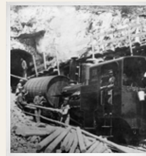
Bau der beiden Tunnel zwischen der Station Baumgartner und dem Bergbahnhof Hochschneeberg
